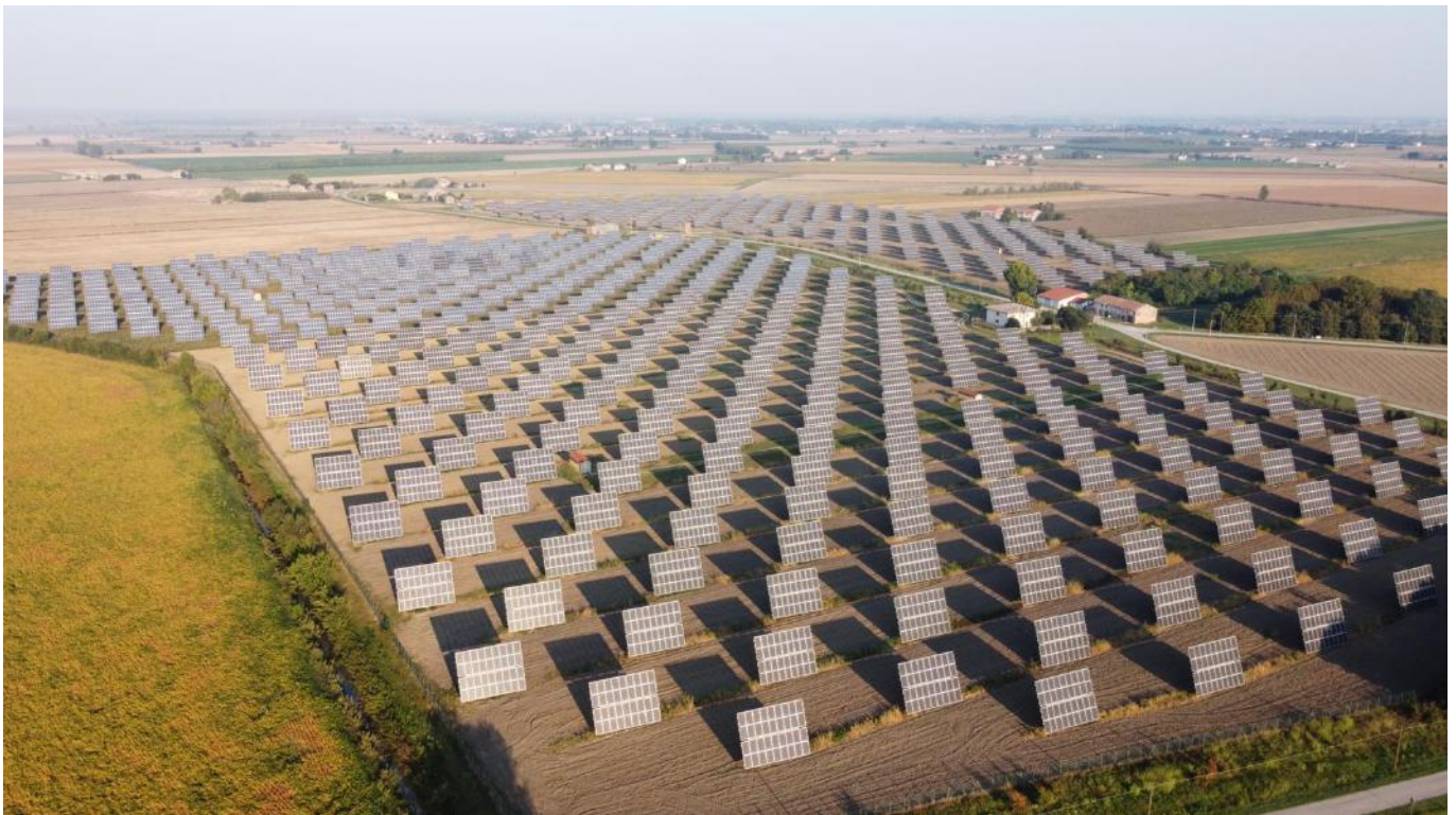
A Castelguglielmo è stato installato un impianto fotovoltaico con moduli bifacciali più efficienti.
